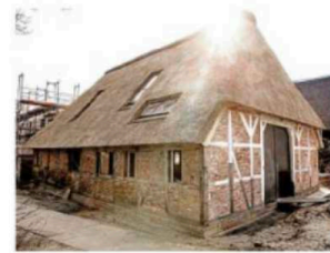
Die alte Scheune in frischem Glanz. Links ist der Neubau zu erkennen.
